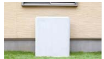
蓄電池のレンタル（NEC製）
